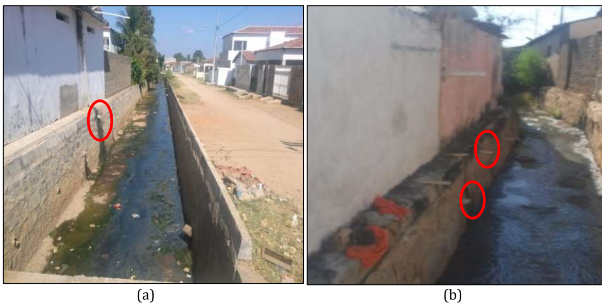
Figura 27 – (a) e (b) Imagens fotográficas de residências ligadas à rede de drenagem pluvial
