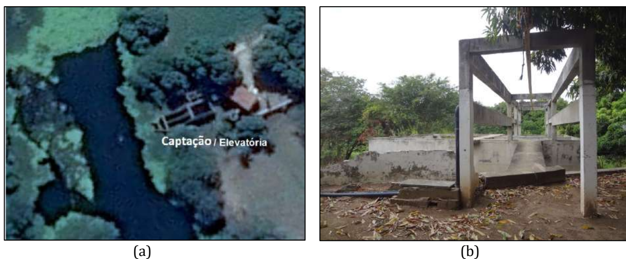
Figura 18 - (a) Imagem de satélite e (b) fotografia da captação e estação elevatória do SAA de Pombal - PB
