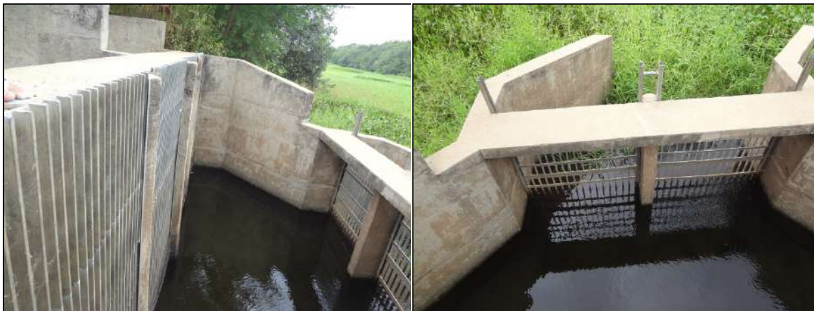
Figura 19 – imagens fotográficas gradeamento na captação do SAA de Pombal – PB
