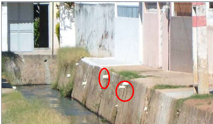
Figura 29 – Imagem fotográfica de extravasores ligados à rede de drenagem pluvial
