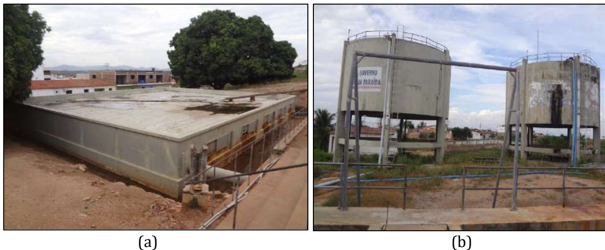
Figura 25 – (a) Imagens fotograficas de Reservatórios de distribuição 1 (b) 2 e 3, respectivamente, do SAA de Pombal – PB
