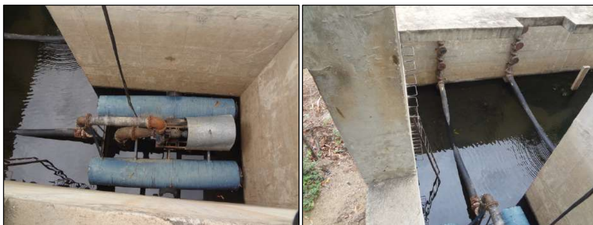
Figura 20 – imagens fotográficas da estação elevatória do SAA
