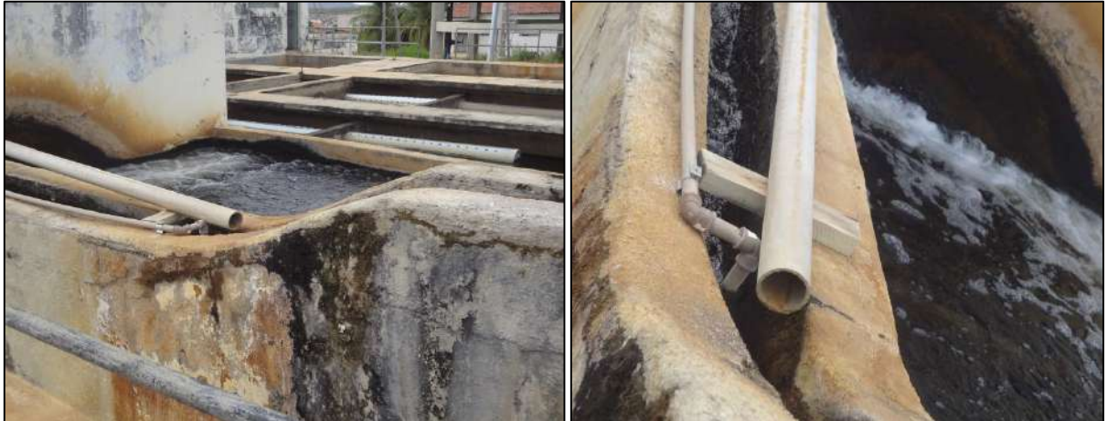
Figura 14 - Dispositivo hidráulico utilizado na etapa de coagulação na ETA de Pombal – PB.
