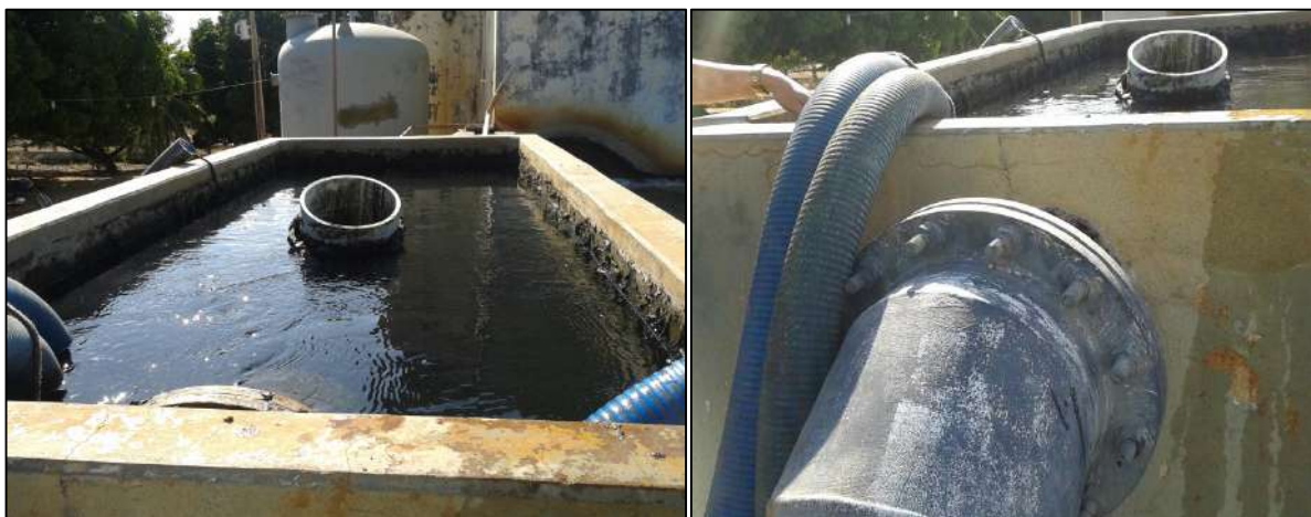
Figura 13 - Tanque para recebimento da água bruta na ETA de Pombal – PB.
