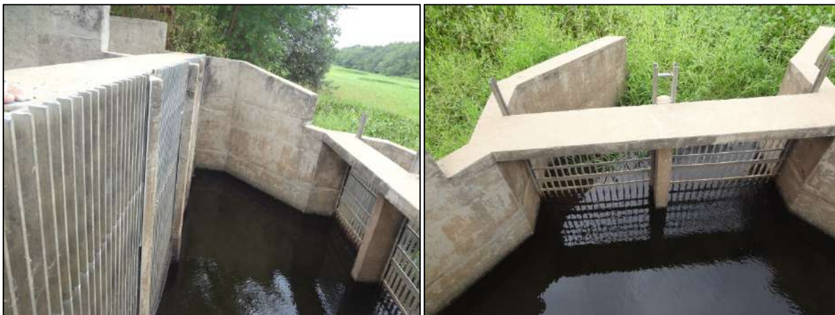
Figura 6 - Gradeamento na captação do SAA de Pombal - PB.
