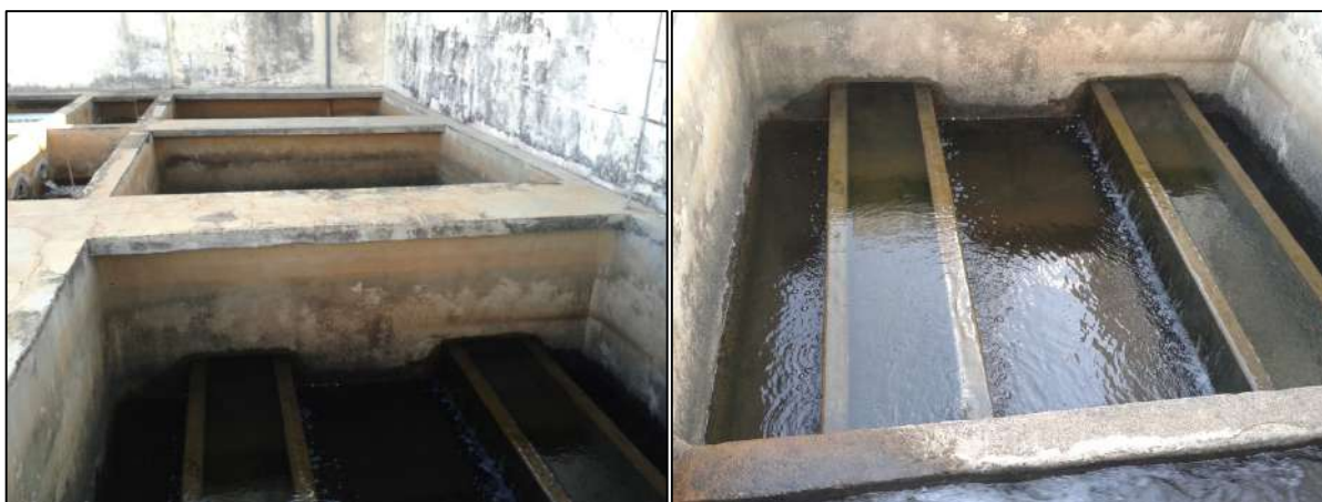
Figura 19 - Filtros de areia da Estação de Tratamento de Água de Pombal – PB.
