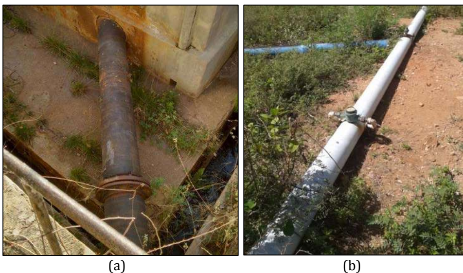
Figura 22 - Adutora de água tratada que conduz água para o reservatório semi-apoiado (a) e para os reservatórios elevados (b).
