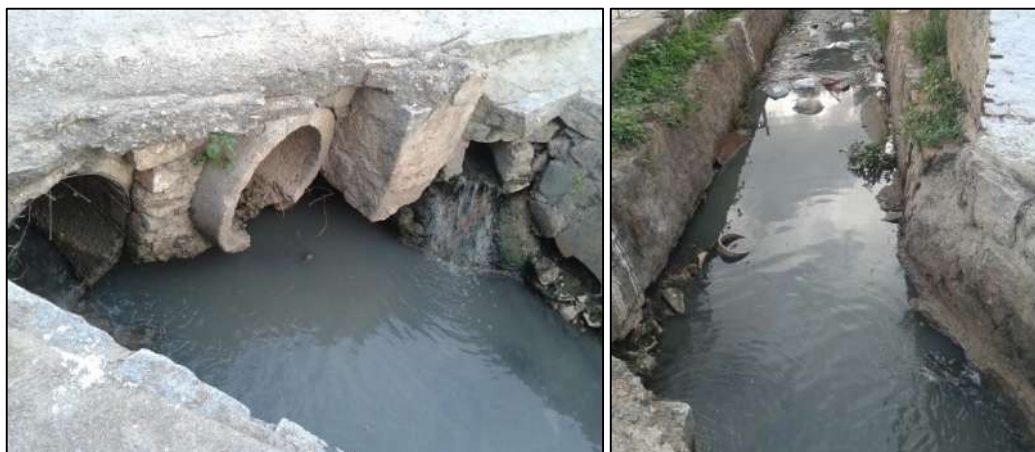
Figura 20 - Galerias de águas pluviais onde são dispostas as águas de lavagem dos filtros da ETA de Pombal – PB.
