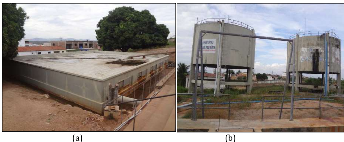
Figura 23 - Reservatórios de distribuição 1 (a) 2 e 3 (b), respectivamente, do SAA de Pombal – PB.
