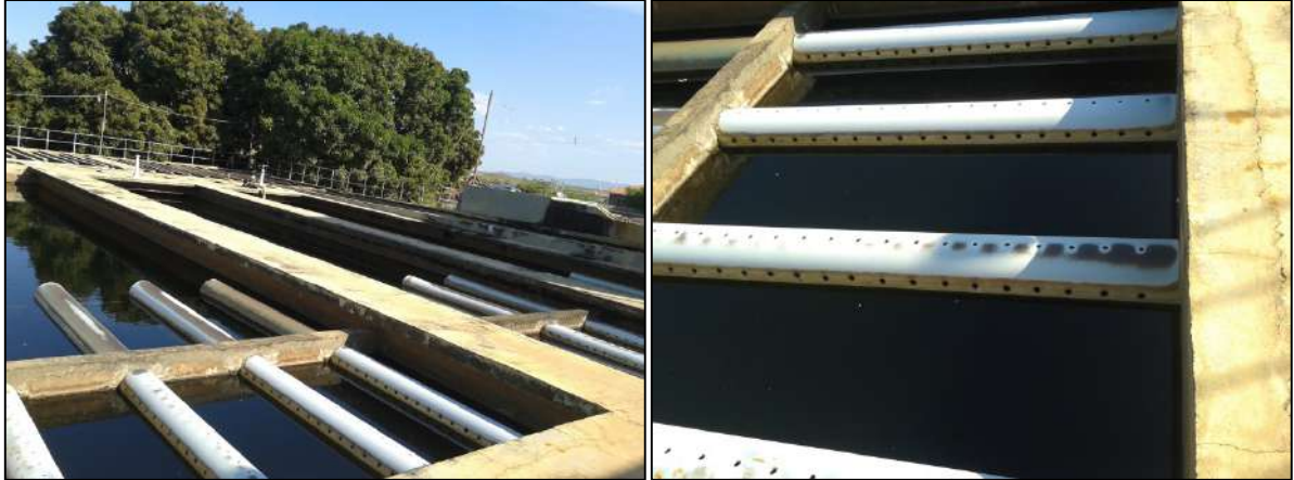
Figura 17 - Decantadores da ETA de Pombal – PB.
