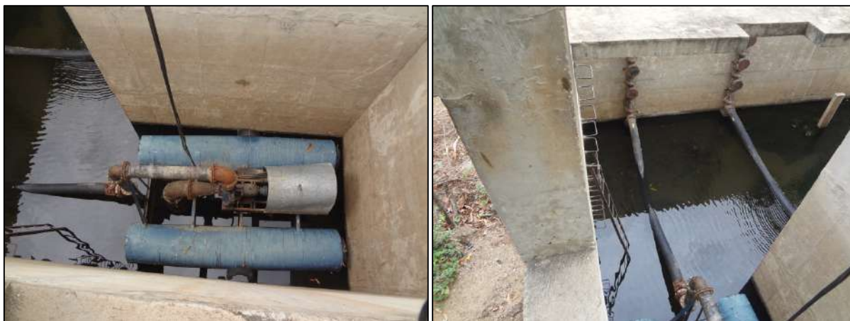
Figura 8 - Estação elevatória do SAA de Pombal – PB.
